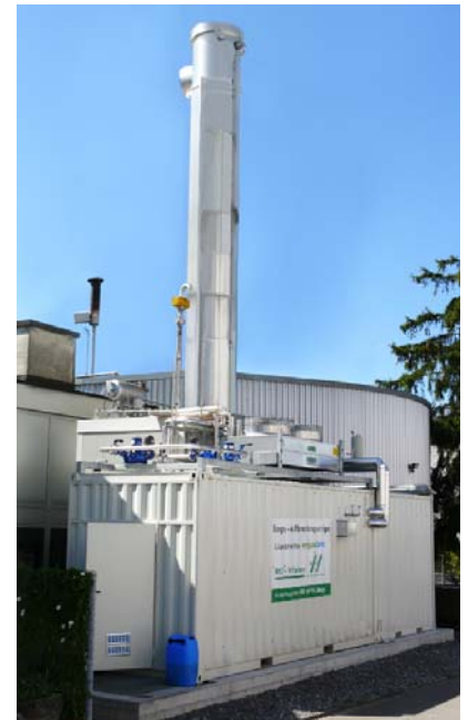
Beispiel: Biogasaufbereitung Meilen, Schweiz Aufbereitung von 100 m 3 /h Klärgas, lokale Einspeisung bei 30 mbar, seit 2008 Foto: DGE GmbH
